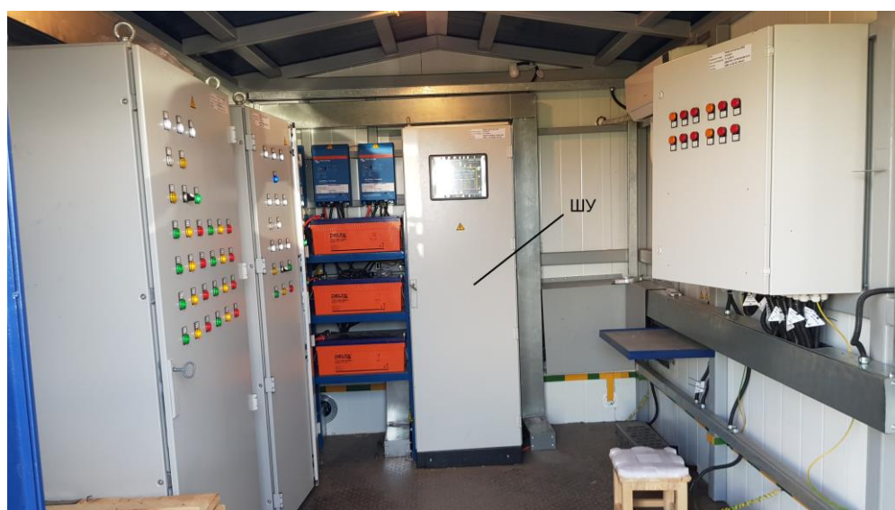
Рисунок 2 – Общий вид смонтированного шкафа управления, содержащего СОИ системы в составе аппаратного блока ИУ-реципиента
